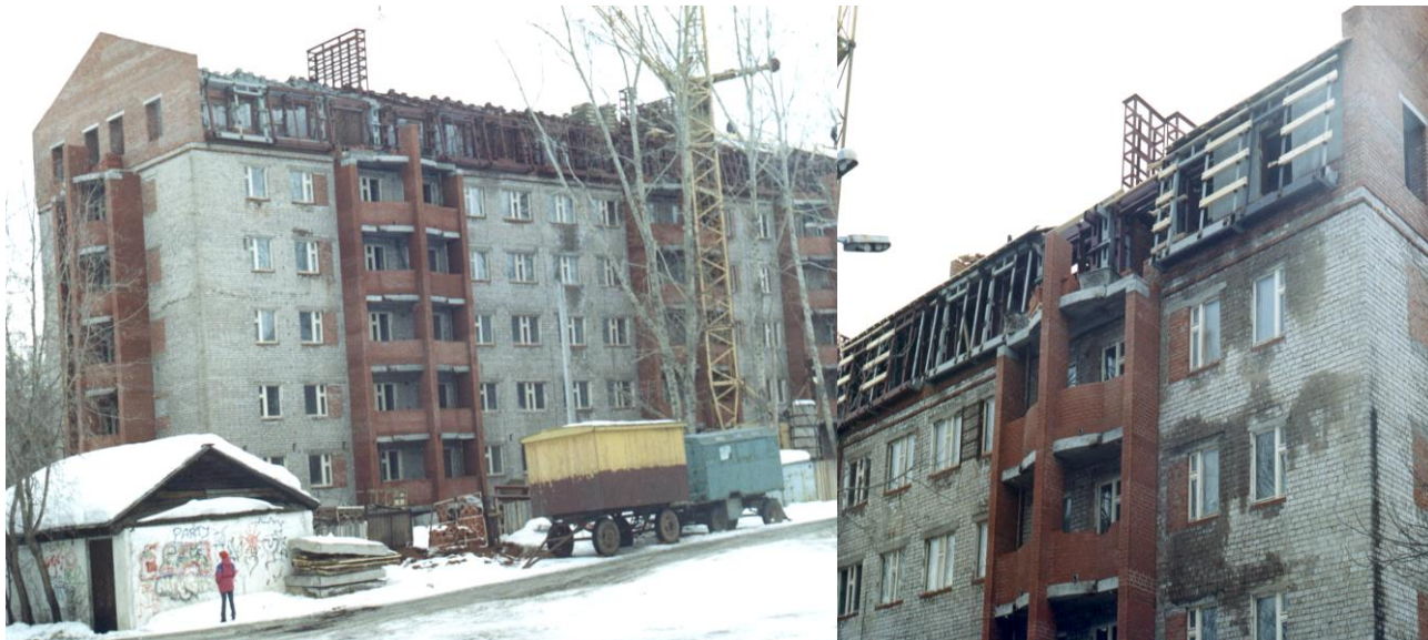
Рис. 1.7. Реконструкция общежития по ул. Авангардная г. Ижевска с устройством мансардного этажа из стальных конструкций. Жильцы дважды обращались в суд, поскольку в зимний период температура в мансардном этаже составляла +5°C. При реконструкции была промочена и проморожена кирпичная кладка
