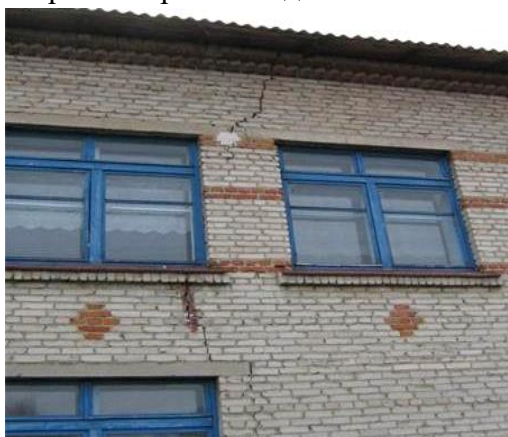
Рис. 1.6. Диагональные трещины в каменной кладке с установленным гипсовым маяком.
