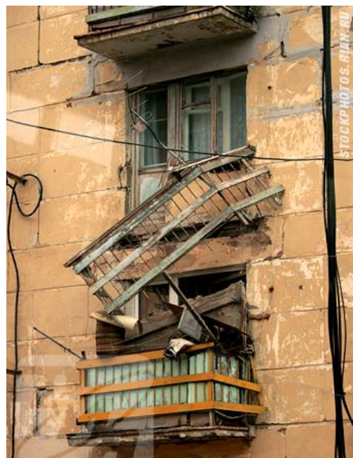
Обрушение балконов в жилом доме в Москве
