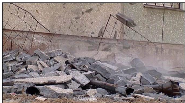
29.03.2011 г. в Невском районе Санкт-Петербурга в пятиэтажном жилом доме на 2-ом Рабфаковском переулке на последнем этаже из-за скопления воды под кровлей здания произошло обрушение облицовочной кирпичной кладки на площади три квадратных метра и козырька над окном пятого этажа. Также произошло отслоение фасадной кирпичной кладки. Никто не пострадал. На улицу были выведены 15 человек, после проведения необходимых ремонтных работ все жильцы вернулись в свои квартиры.
