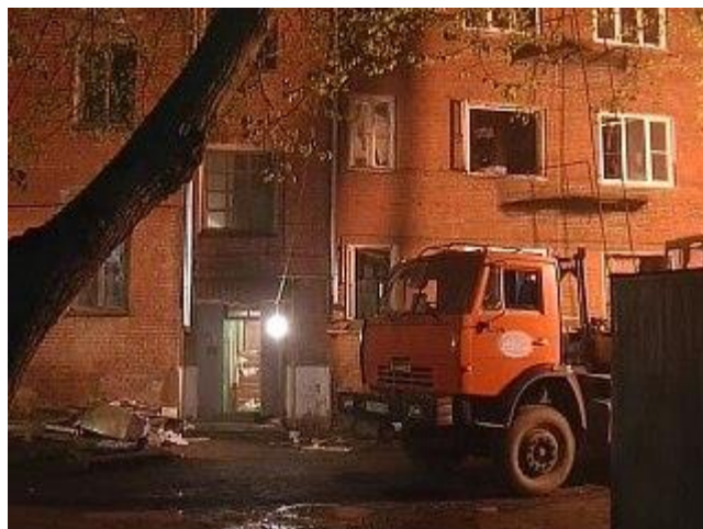
18.05.2011 г. в г. Струнино Владимирской области обрушились деревянные перекрытия четырехэтажного кирпичного здания 1928 г. постройки на улице Советская, 10. В доме проживали 89 человек
