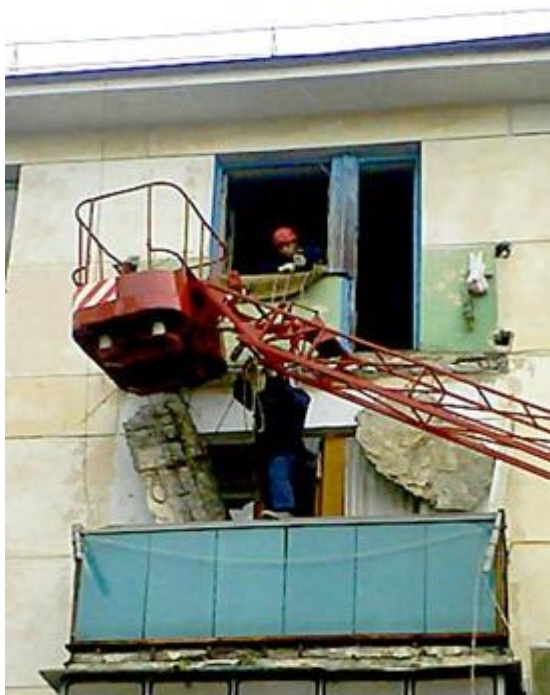
13.03.2008 г. в Новороссийске обрушился балкон, расположенный на четвертом этаже пятиэтажного дома. В результате происшествия погибли две женщины, еще одна пострадала.
