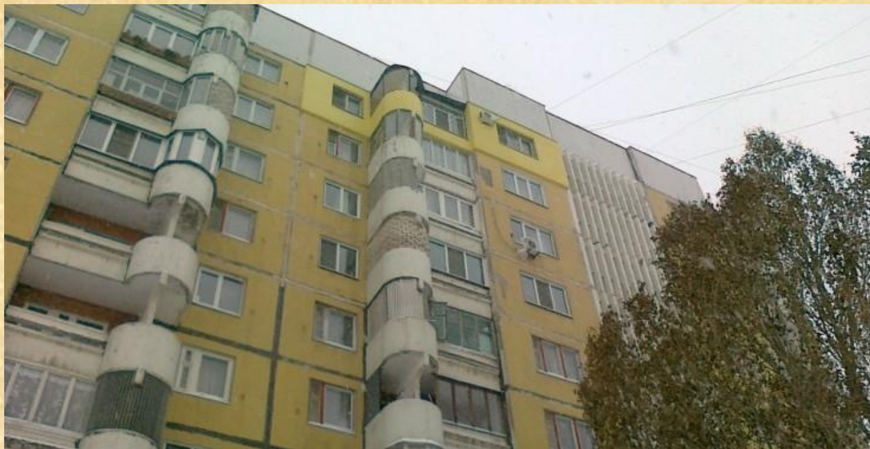
Хаотичное утепление фасадов крупнопанельных зданий в Самаре
